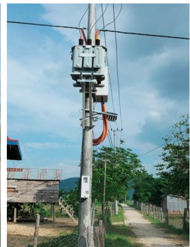
Trạm biến áp Bôn Biah B
