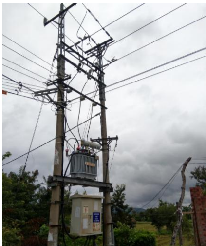
Trạm biến áp Ia Tul 2
